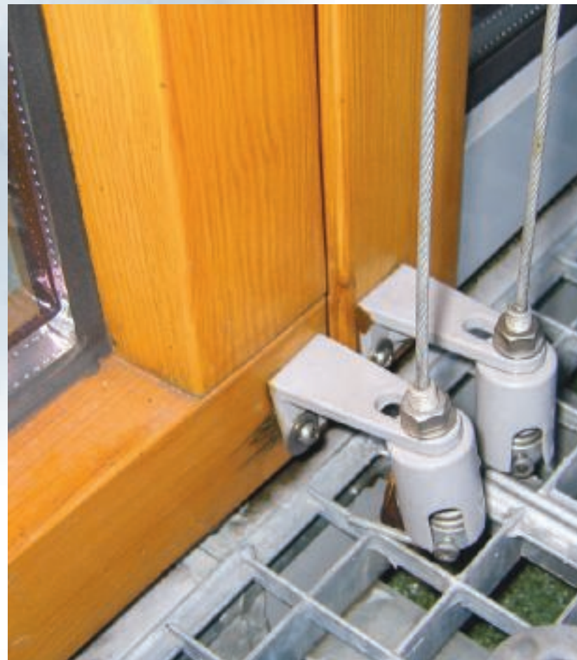
Fäulnisschaden unter einem Spannselhalter
